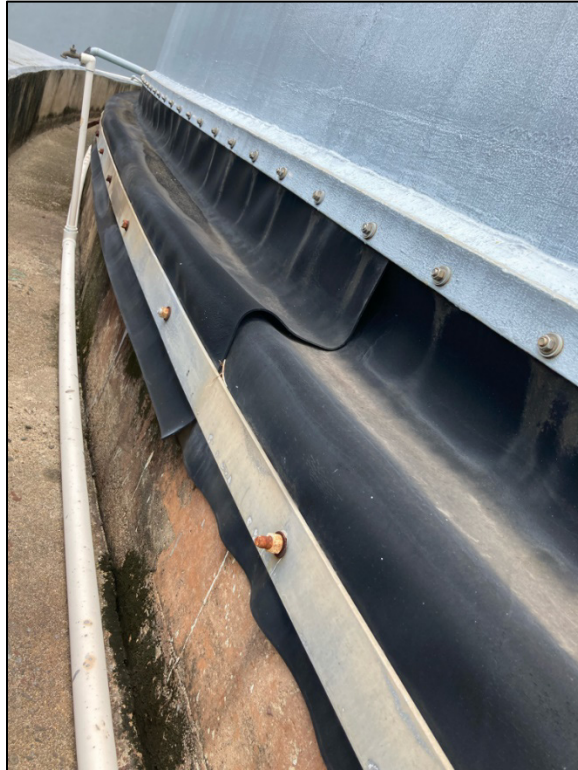
PL-4. Espacio de separación en el sellado de goma en la base del domo
