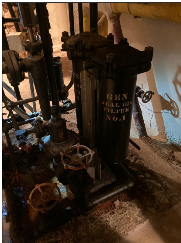
PL-1. Sustancia aceitosa observada en la Junta del Filtro de Aceite No. 1 del Generador
