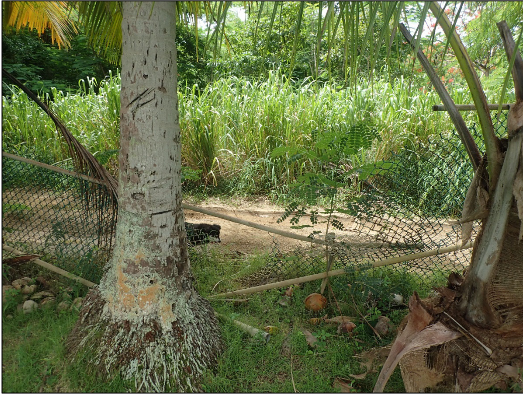
PL-6. Daños en la verja del perímetro de seguridad
