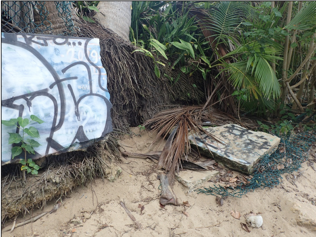
PL-9. Daños en el muro de barrera de la playa
