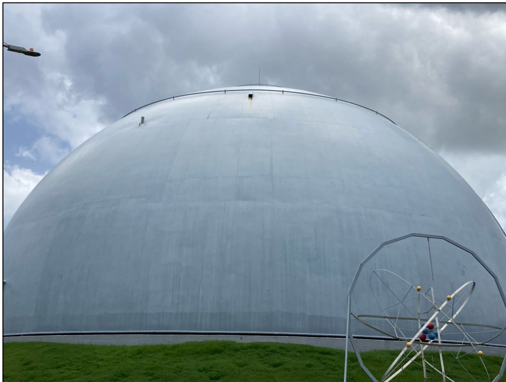
PL-3. Cúpula de contención
