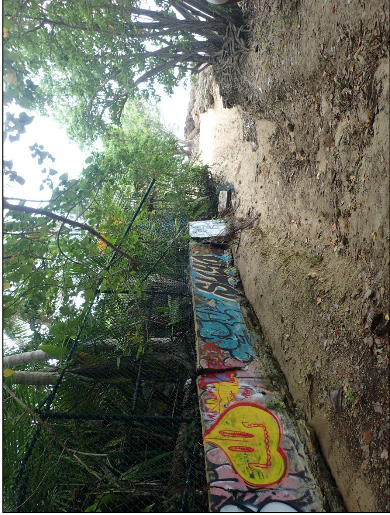
PL-10. Daños en el muro de barrera de la playa
