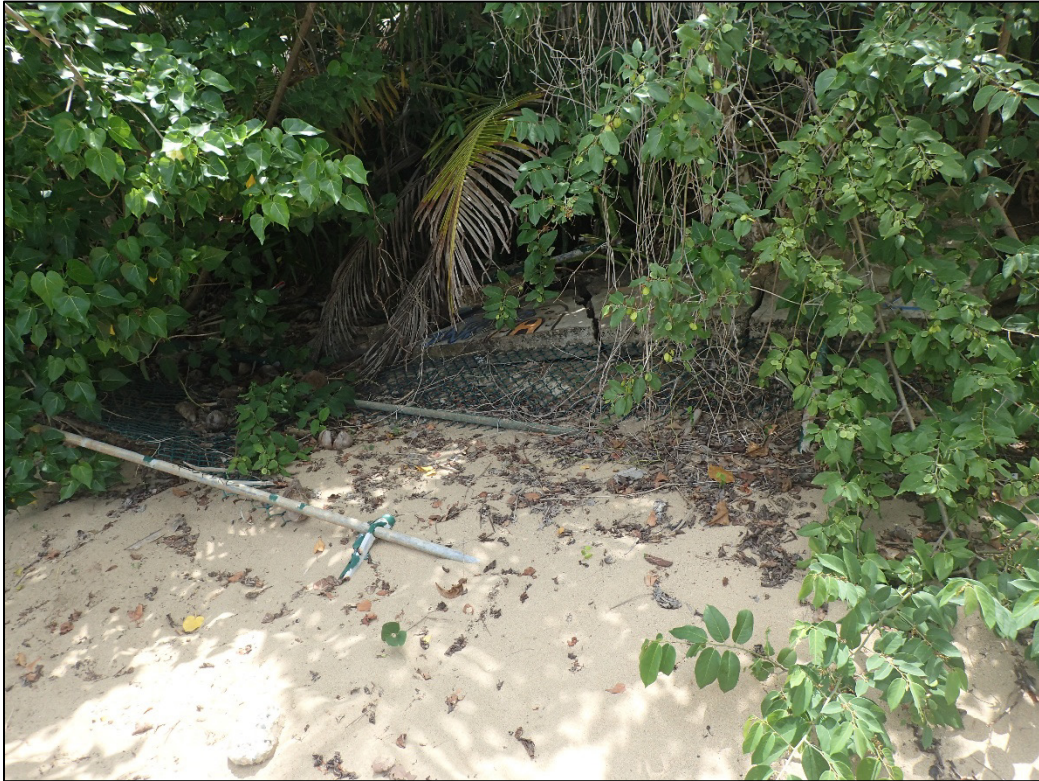
PL-8. Daños en el muro de barrera de la playa y verja de seguridad caída
