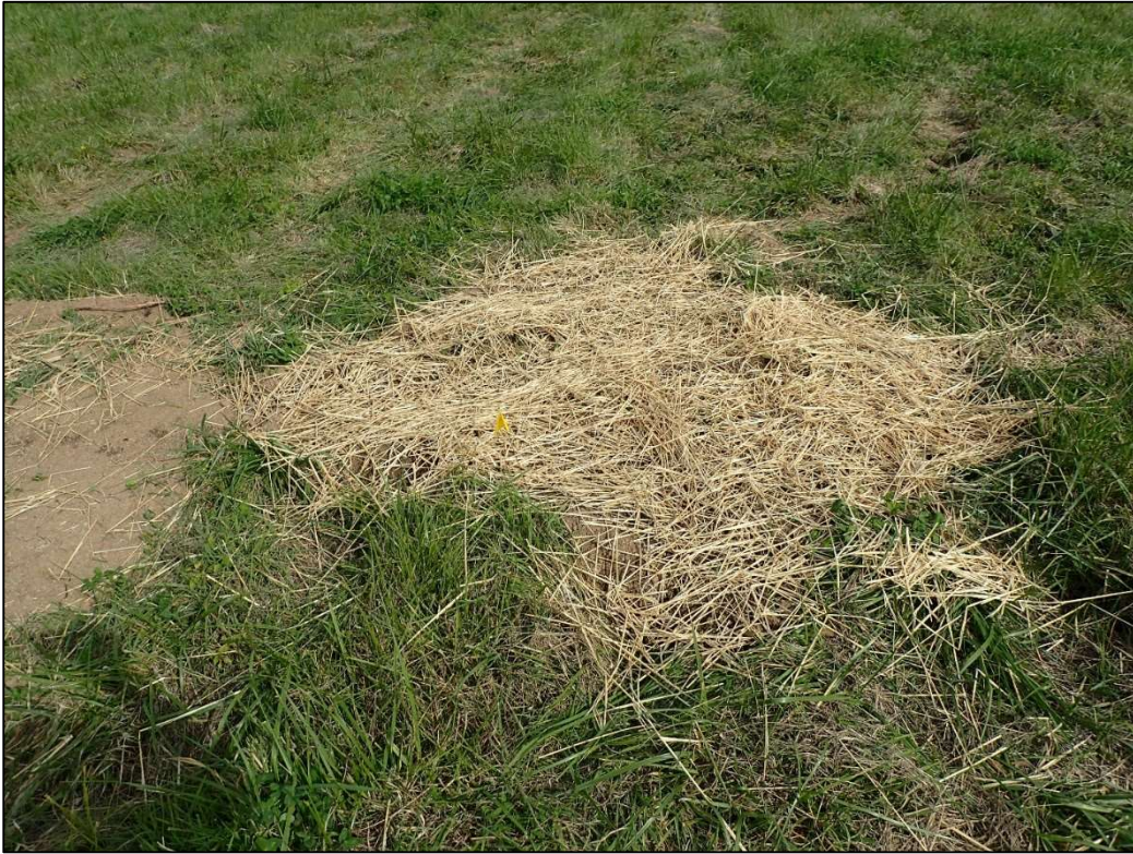
PL-7. Collapsed Animal Burrow
