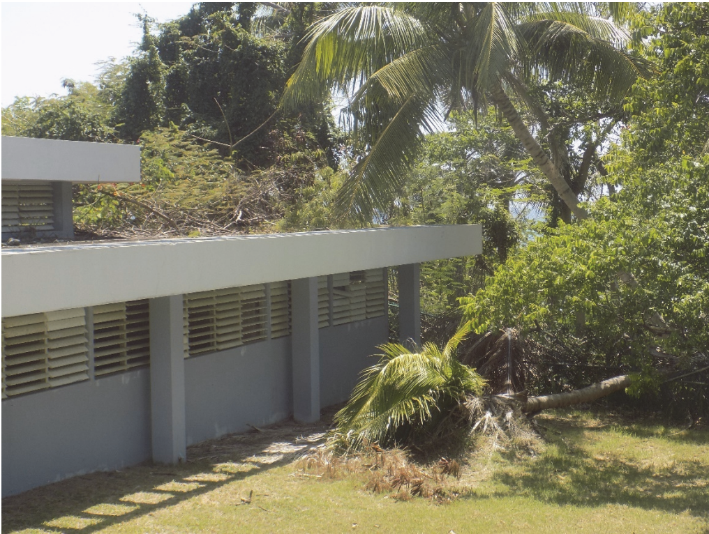
PL-5. Árbol caído sobre el techo del edificio de entrenamiento
