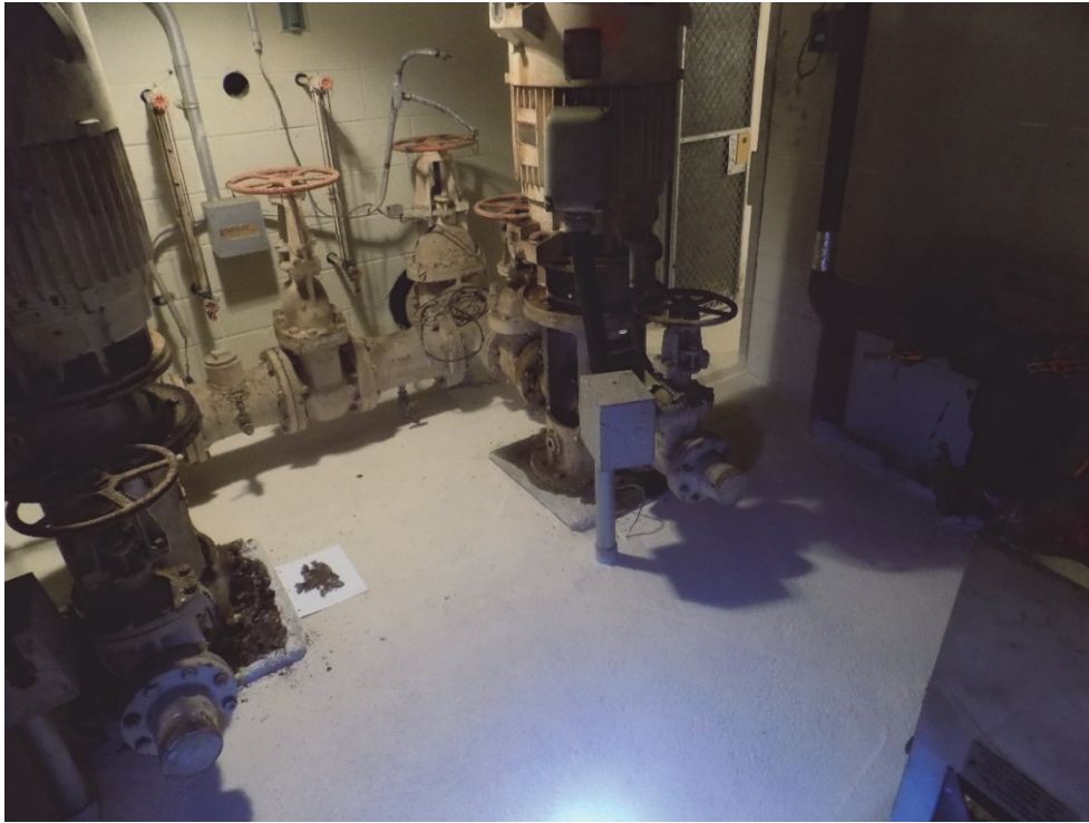
PL-2. Restos oxidados contaminados y manchados de aceite en la base de la bomba de condensación en el sótano del edificio de contención
