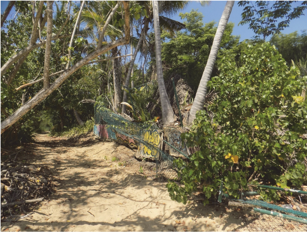
PL-4. Daños en la verja de seguridad
