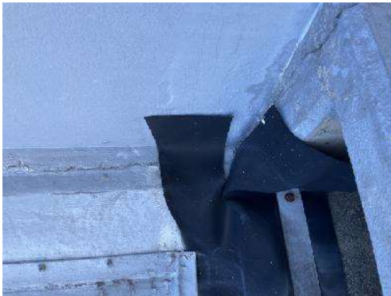
PL-3 Sellado a lo largo de la base del domo de contención
