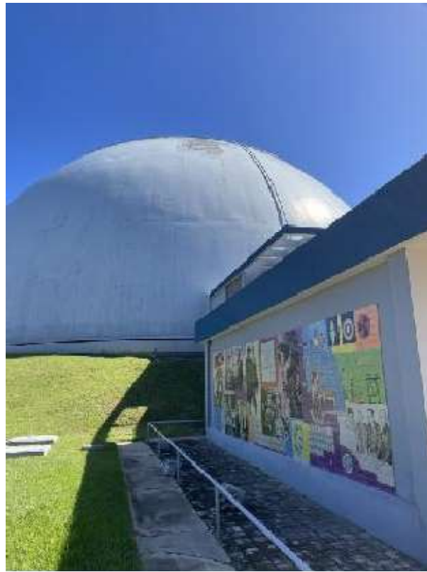
PL-2 Deterioro en la pintura del domo de contención
