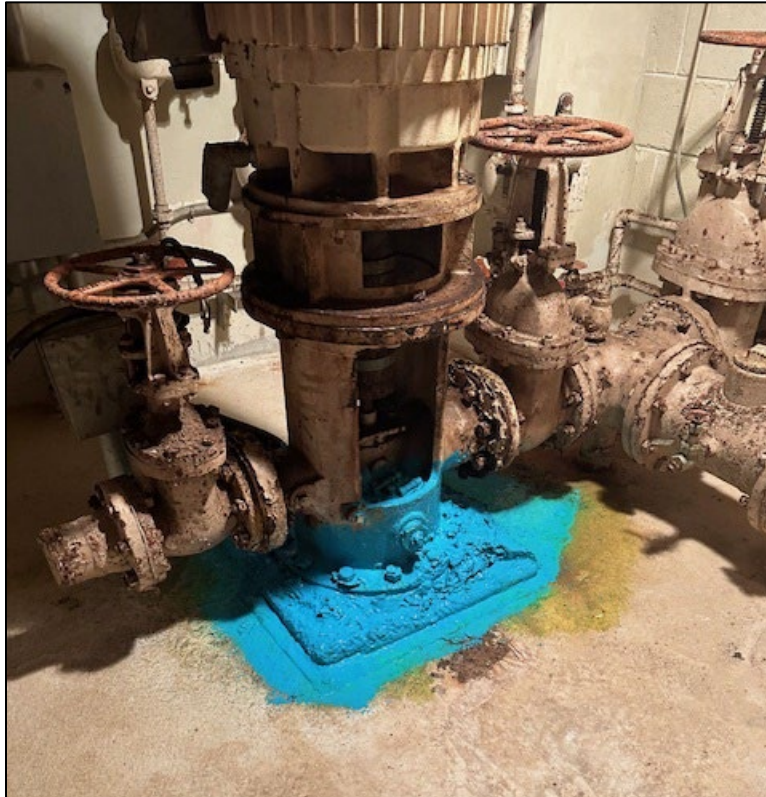
Figura 1. Bomba en la zona de contaminación del sótano a la que se aplicó fijador en 2024
