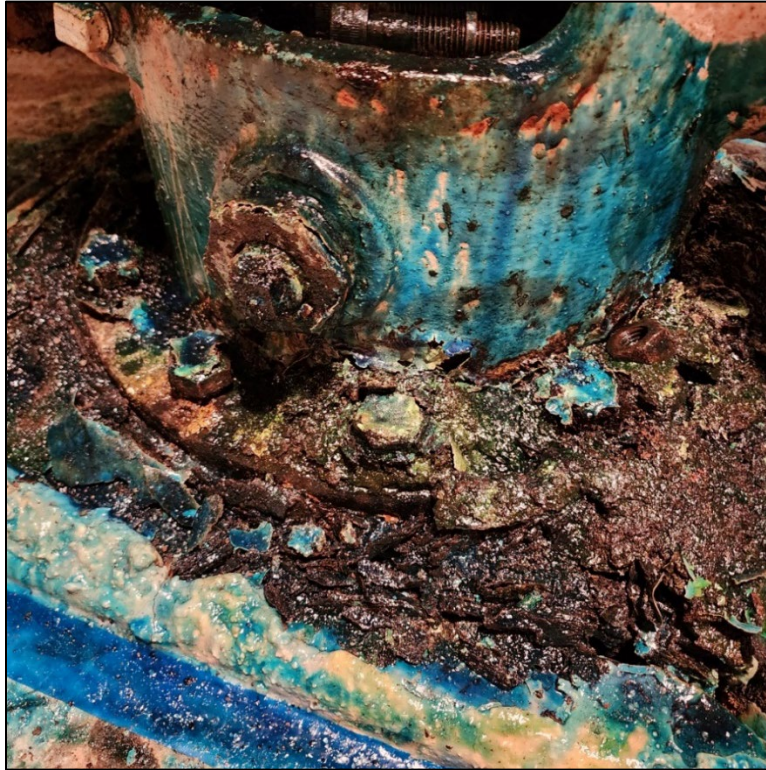
Figura 2. Primer plano de la bomba en la zona de contaminación del sótano en 2025
