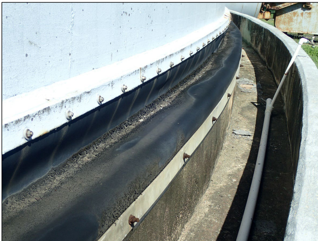
PL-3. Sellado en la base del domo de contención
