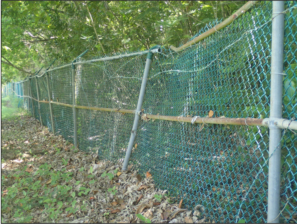
PL-6. Deterioro en la verja del perímetro
